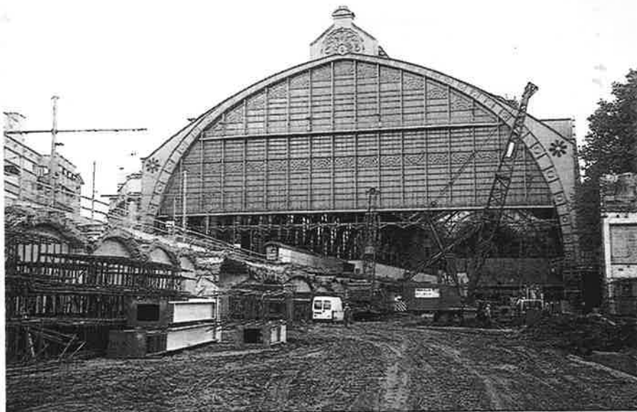
Op 30-9-99 staan we in de bouwput te Antwerpen Centraal. De beruchte catacomben zijn reeds voor de helft afgebroken terwijl boven de andere helft de treindienst zich beperkt afwikkelt. De kranen graven slipwanden tot in de Boomse klei, want het onderste niveau zal nog 18 meter lager zijn dan de fotograaf zich bevindt. Foto : Erik Heylen.
